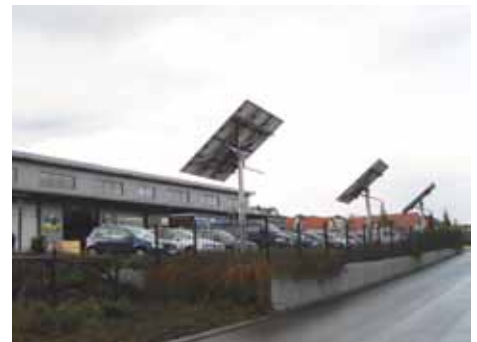
Diese auf Masten montierten Solarmodule lassen sich von hinten untersuchen, um Reflexionen zu minimieren.
