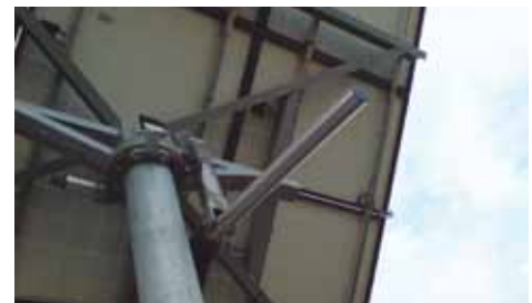
Die Untersuchung von der Rückseite zeigt keine heißen Stellen; die heißen Stellen in dem vorhergehenden Wärmebild, das von vorne aufgenommen wurde, waren durch Reflexionen bedingt.
