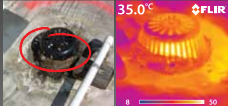
Das Wärmebild zeigt Wasserlecks im Flachdach.
