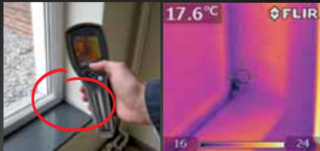
Die kalte Stelle weist auf kalte Luft hin, die beim Fenster eindringt.
