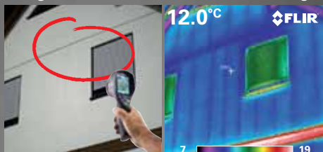
Eine fehlende Dämmung wird in der Wand erkannt. Zusätzlich wird die Ständerkonstruktion sichtbar.
